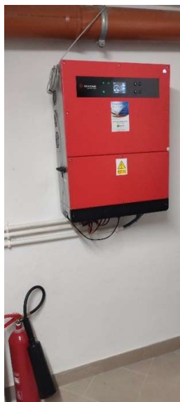
Falownik umiejscowiony w budynku Akademii – jego dokładna lokalizacja została przedstawiona na planach obiektu
